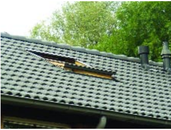
Per woning kwam een vierpans dakraam met isolatieglas met een relatief grote lichtinval.
