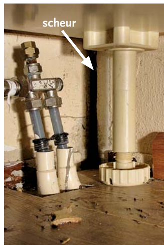
De binnen- en buitenmuur en de vloer zijn losgescheurd op nummer 21. Foto: Antoine Tabbers
