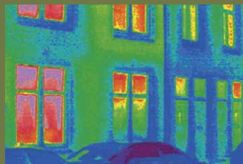
Foto links: Sina Fischer (l) en René Fleur overhandigen het rapport van de Energiebus aan Mitros-directeur Karin Verdooren. Foto rechts: Infraroodfoto van enkele woningen in de Potgietenstraat.
