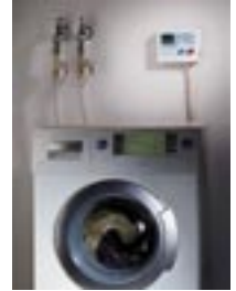
Hot fill aansluiting op een wasmachine.
